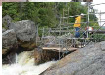
Rivière Mistassini. Structure pour dynamitage du bloc rocheux. Photo : WSP Canada Inc
