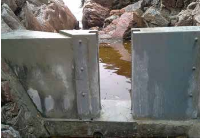
Rivière Moisie. Muret de protection avec sa plaque protectrice. Photo: APRM
