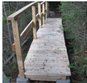
Rivière Mistassini. Nouvelle structure facilitant la surveillance de la rivière. Photo : OBVM
